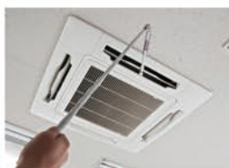
空调出风口测试
