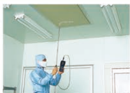
高效过滤器出风口测试
